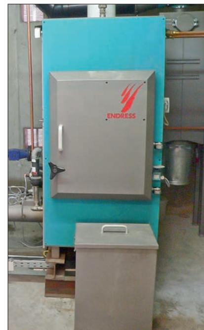
Kessel mit automatischer Holzzuführung, im Vordergrund der Aschebehälter, der für mehrere Wochen reicht.
