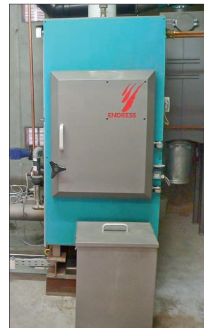
Kessel mit automatischer Holzzuführung, im Vordergrund der Aschebehälter, der für mehrere Wochen reicht.
