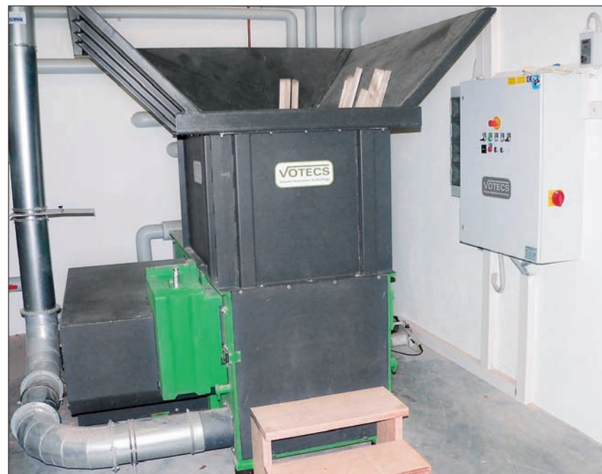
Zur Anpassung des Hackers gehört auch ein Aufsatz auf dem Trichter, der das Befüllen per Stapler erleichtert. Links ist die Förderleitung für die Hackschnitzel zu sehen, die zum Silo führt. Fotos: Ißleib (4), Neugebauer (1)
